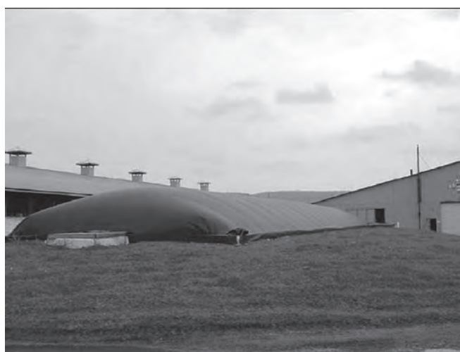
รูปที่ 7 ระบบบ่อหมักกราง (Plug flow anaerobic digester)
