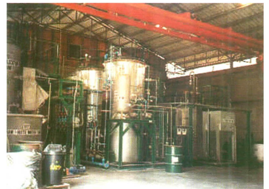
โรงงานต้นแบบระบบบำบัดน้ำเสียนขนาด 10 ลบ.ม.
