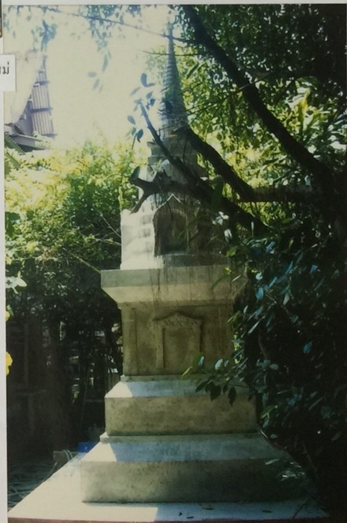
ชั้นรากฐาน ตีเข็มรองรับน้ำหนักทั้ง ๔ มุม
