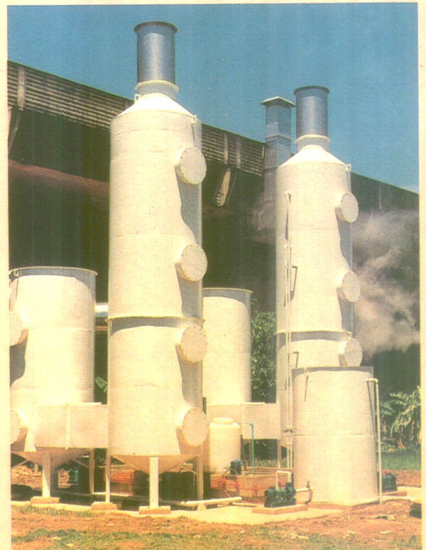
ระบบขจัดไอกรด ไอต่าง แบบ Wet Scrubber
