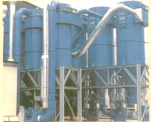
การขจัดฝุ่นในโรงงานอุตสาหกรรมด้วยระบบ Bag House แบบ Jet Pulse
