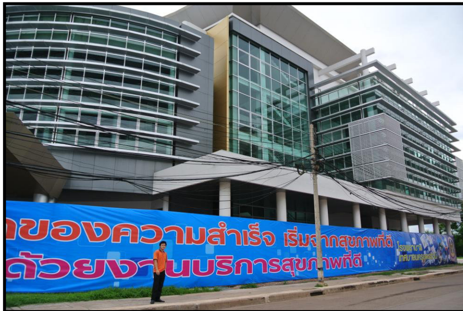
ภาพที่ 5.9 โครงการก่อสร้าง “ศูนย์บริการสาธารณสุขเทศบาลนครอุดรธานี” ถนนอุดรดุขฎิ อ.เมือง จ.อุดรธานี
