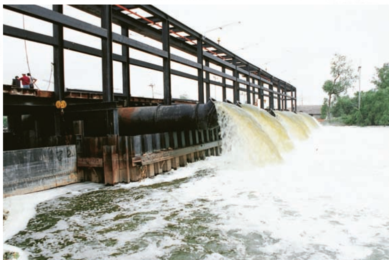
玛哈猜排水闸与吸水站
