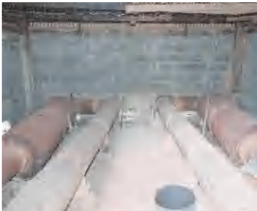
ภายในโรงบ่มใบยาสูบมีท่อทำความร้อนและระบายอากาศ
