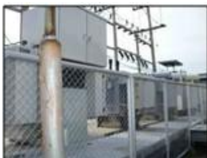
รูปแสดงหม้อแปลงไฟฟ้า
