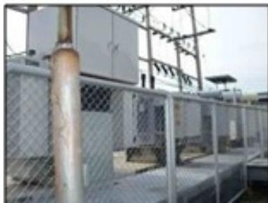
รูปแสดงหม้อแปลงไฟฟ้า
