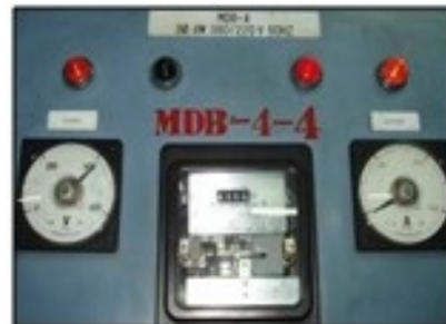
รูปแสดงแรงดันไฟฟ้าที่ MDB-4-4 ก่อนปรับลดแรงดันไฟฟ้า
