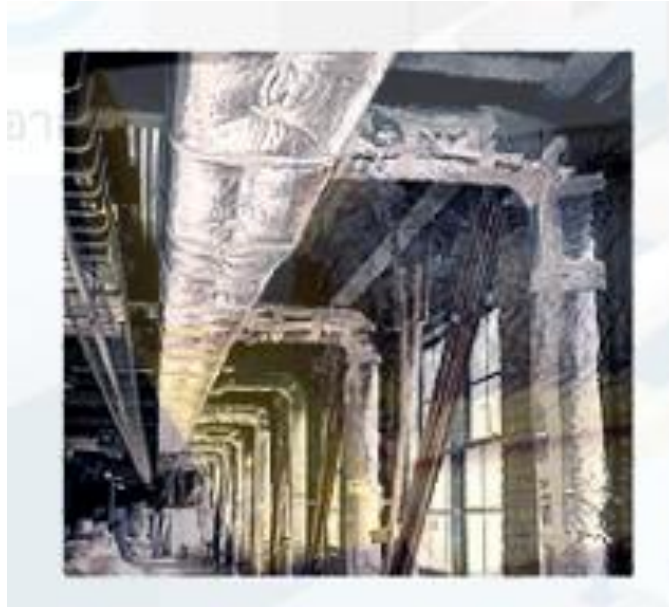
รูปที่ 8-27 ฉนวนท่อลม
