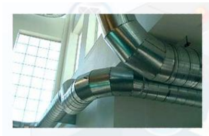
รูปที่ 8-30 ท่อลม
