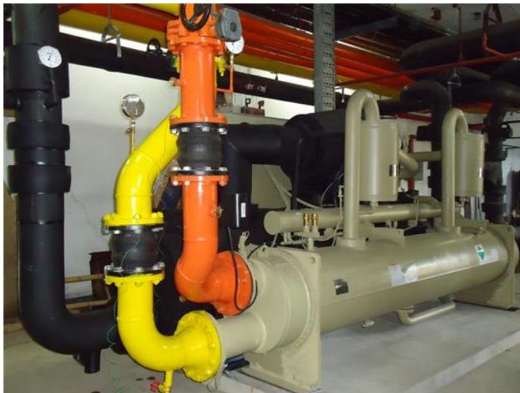
รูปที่ 8-17 เครื่องทำน้ำเย็นในระบบปรับอากาศแบบรวมศูนย์
