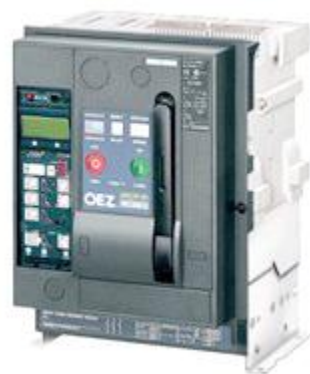
รูปที่ 6-9 Air Circuit Breaker
