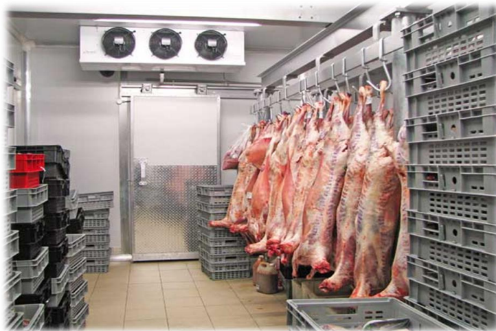
รูปที่ 8-11 ห้องแช่แข็งแบบการพาความร้อน (ห้องเย็นในโกดังเก็บสินค้า)
