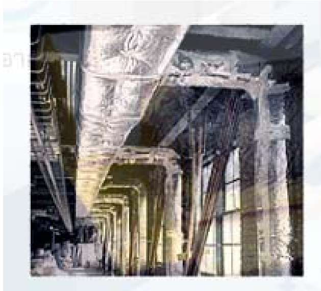
รูปที่ 8-27 ฉนวนท่อลม
