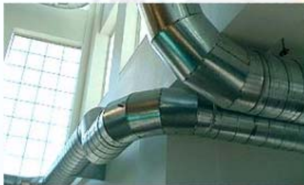
รูปที่ 8-30 ท่อลม
