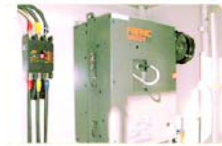
รูปหลังการปรับปรุง ติดตั้งอุปกรณ์ควบคุมความเร็วรอบ
