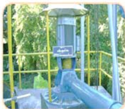
รูปแสดงก่อนการปรับปรุง เครื่องสูบน้ำขนาด 37 kW
