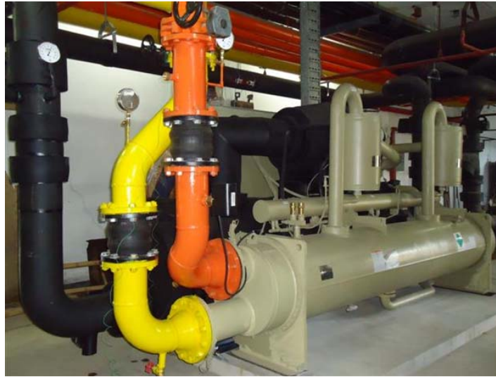
รูปที่ 13-21 เครื่องทำน้ำเย็นในระบบปรับอากาศแบบรวมศูนย์
