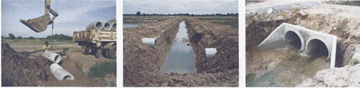
ภาพที่ ๔.๖ การวางท่อคอนกรีตในคันดิน/คันนา/ทางลำเลียงให้น้ำเค็มไหลออกจากแปลงนา
