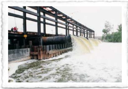
Das Mahachai Stauwehr mit Hochwasserpumpen im Westen des Großraums Bangkok, eine der Anlagen des Hochwasserschutzsystems benannt „Kaem Ling“.
