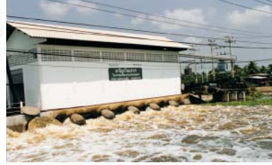
Eine im Osten des Großraums Bangkok gelegene Hochwasserpumpstation, eine der Anlagen des Hochwasserschutzsystems benannt „Kaem Ling“.
