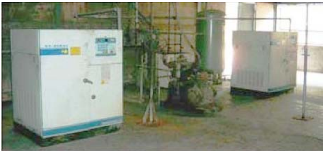
รูปที่ 2-3 ระบบอัดอากาศในโรงงาน
