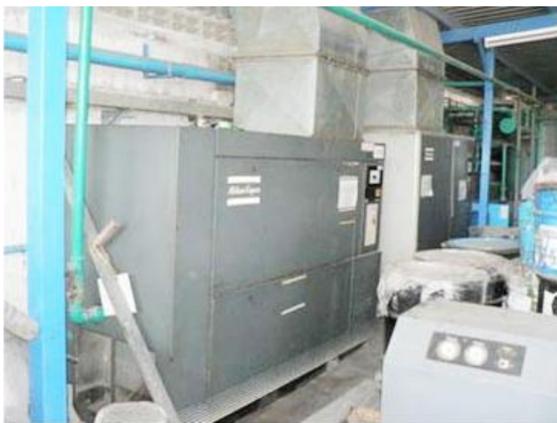
รูปที่ 2-4 ระบบอัดอากาศในโรงงาน
