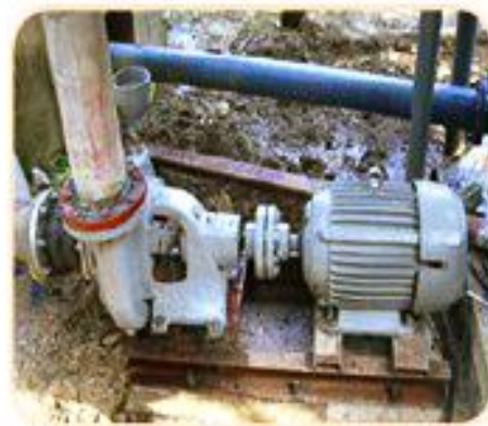
รูปแสดงหลังปรับปรุง เครื่องสูบน้ำขนาด 22.5 kW
