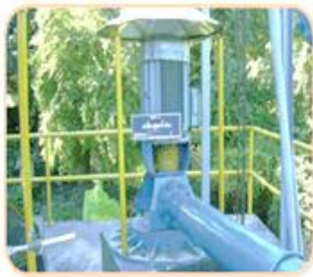
รูปแสดงก่อนการปรับปรุง เครื่องสูบน้ำขนาด 37 kW
