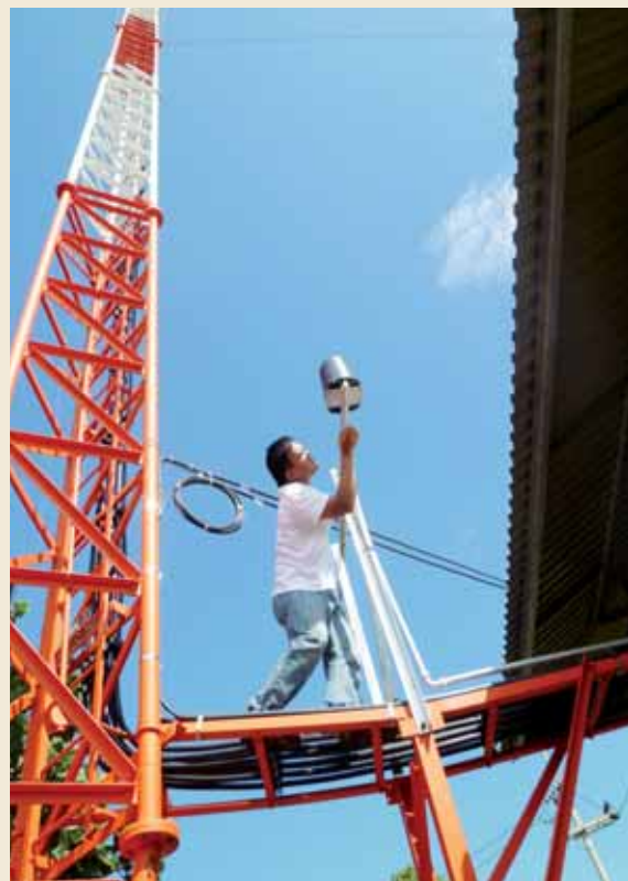
เจ้าหน้าที่ดำเนินการตรวจเช็คสถานีโทรมาตร
